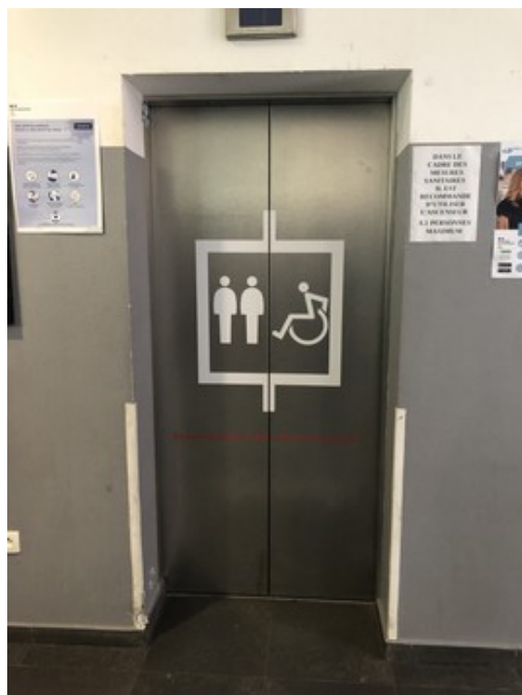
Illustration : Ascenseurs accessibles au rez-de chaussée.
